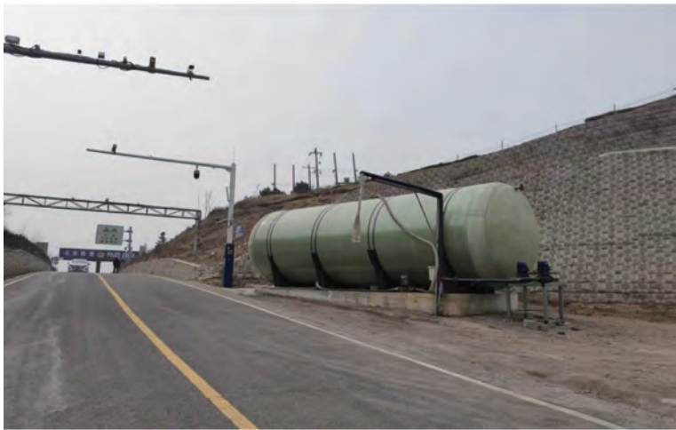
图 23 京冀交界处环保无氯融雪剂储备罐
