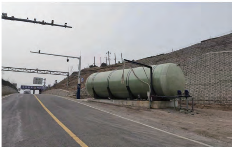
图 23 京冀交界处环保无氯融雪剂储备罐
