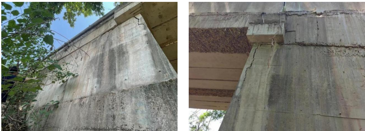
图 3 施工前桥台病害照片
